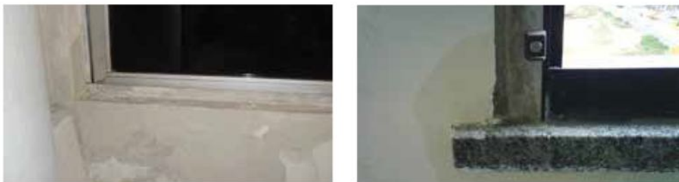
Deformações no contramarco e ocorrências de infiltrações.
