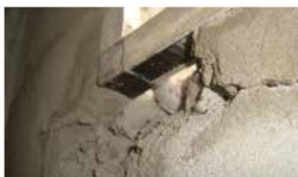
Utilização de Conexão de Nylon - A argamassa desprende-se e o contra-marco pode ficar solto.
